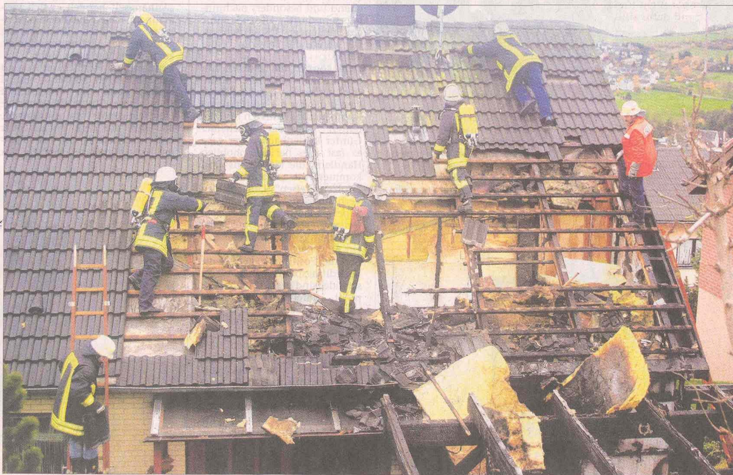
Schwieriger Einsatz: Zahlreiche Wehrleute suchen auf dem zerstörten Dach nach Brandnestern.
